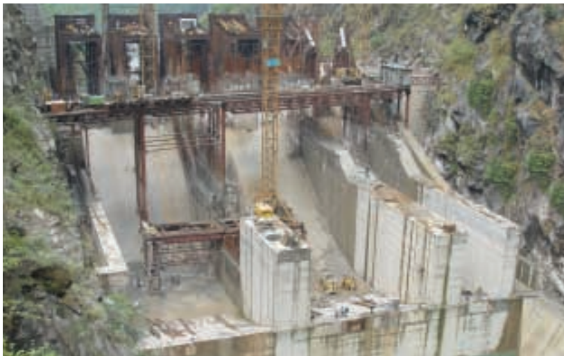
भूटान में तला हाइड्रो-इलेक्ट्रिक परियोजना में निर्माणाधीन 92 मी. ऊँचा कंकरीट ग्रेविटी बांध जिसे भारतीय परियोजना निर्यात कंपनियों अर्थात लार्सन एण्ड टुब्रो लिमिटेड, जयप्रकाश इंडस्ट्रीज लिमिटेड, हिंदुस्तान कंस्ट्रक्शन कंपनी लिमिटेड और भारत हेवी इलेक्ट्रिकल्स लिमिटेड द्वारा निष्पादित किया जा रहा है।
